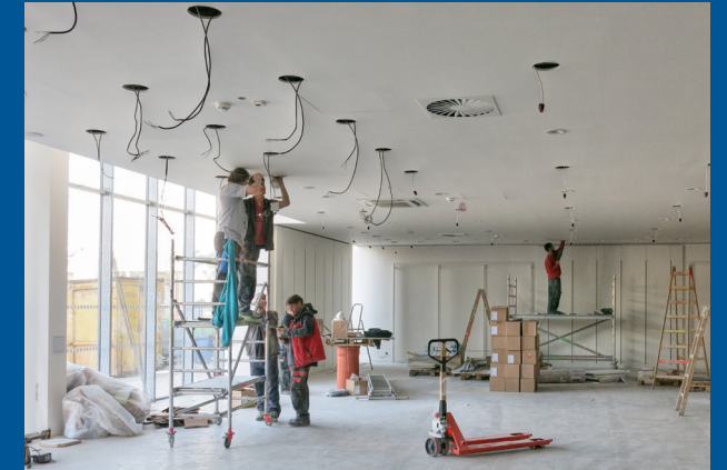
Instalace SIL, SLP - obchodní centrum Rotunda, Havířov
